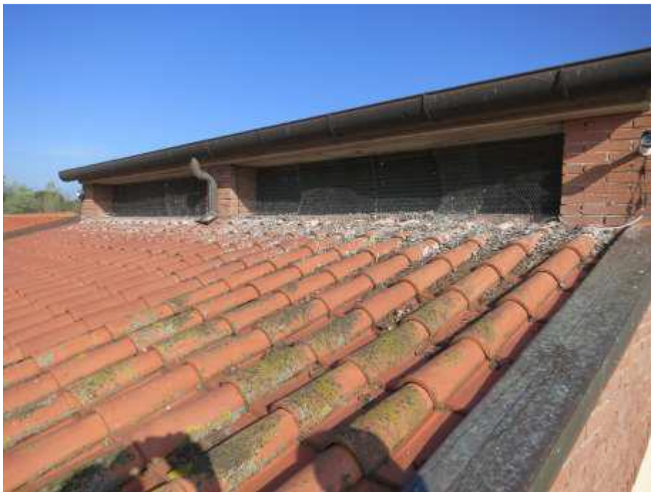
Figura 1. Tetto sud prima della pulizia e del trattamento.
