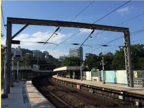
1 Pórtico de catenaria con nidos
